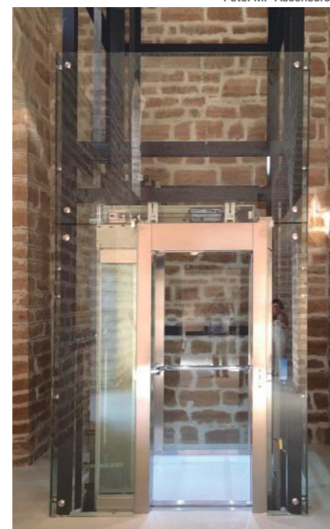
Foto: MP Ascensores
