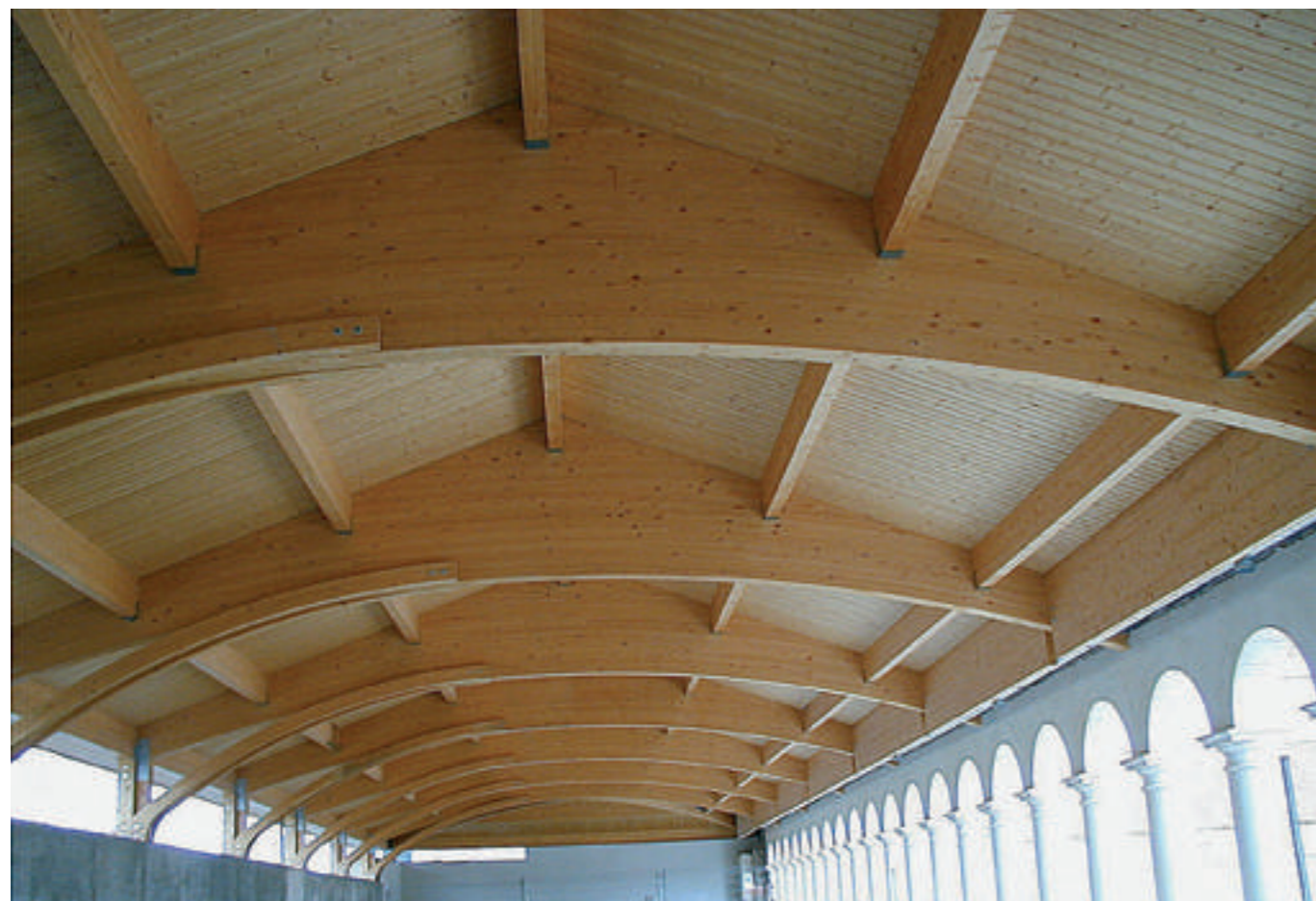
Estructura de arcos en madera laminada, sobre la que se asienta una cubierta del mismo material. Foto: TRC
