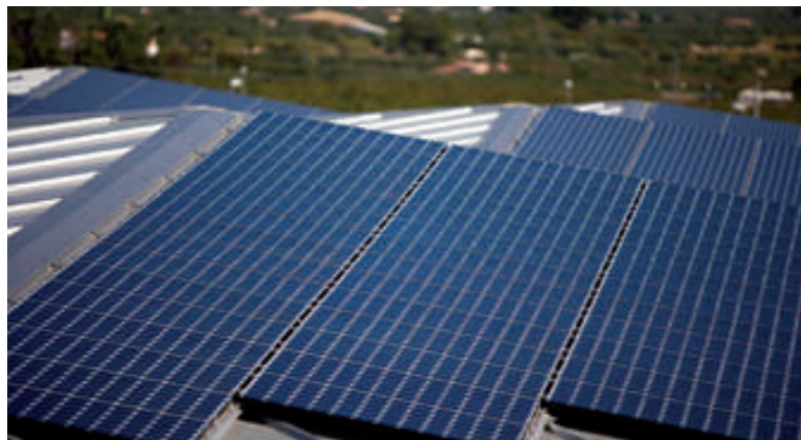
Instalación Fotovoltaica sobre las naves de fabricación. Foto: Actiu
